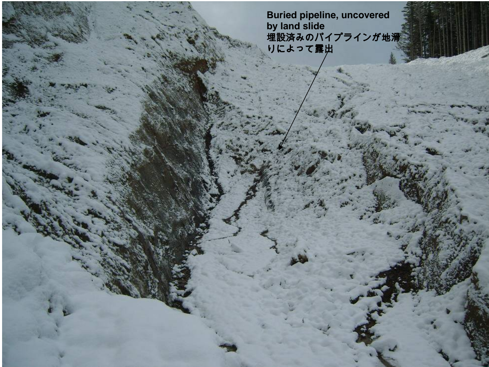
KP 482,6. Primorskaya川の右岸における最近の地滑り ( ドリンスク地区 ) KP 482,6. The fresh landslides on the right bank of the Primorskaya river, Dolinsk District.
