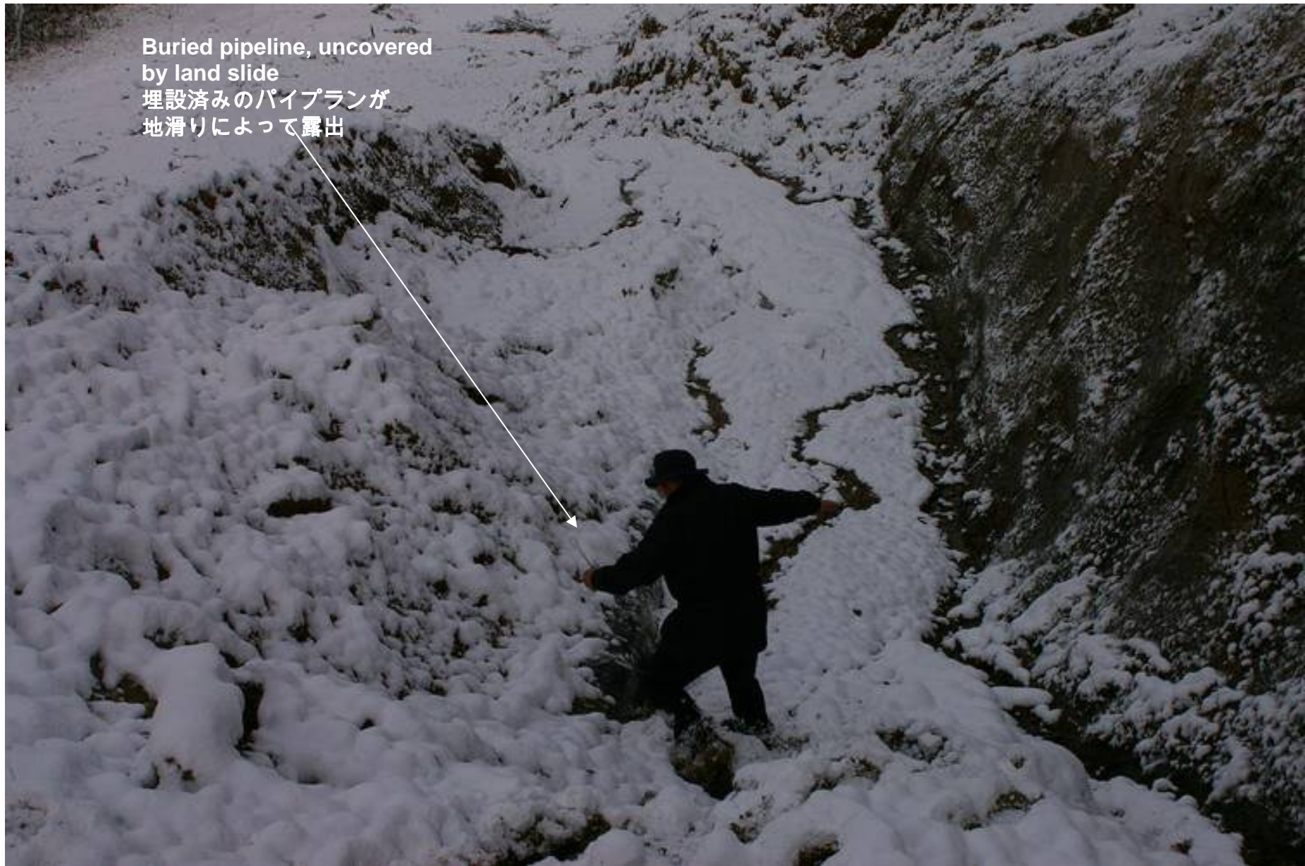
KP 482,6. Primorskaya川の右岸における最近の地滑り ( ドリンスク地区 )
