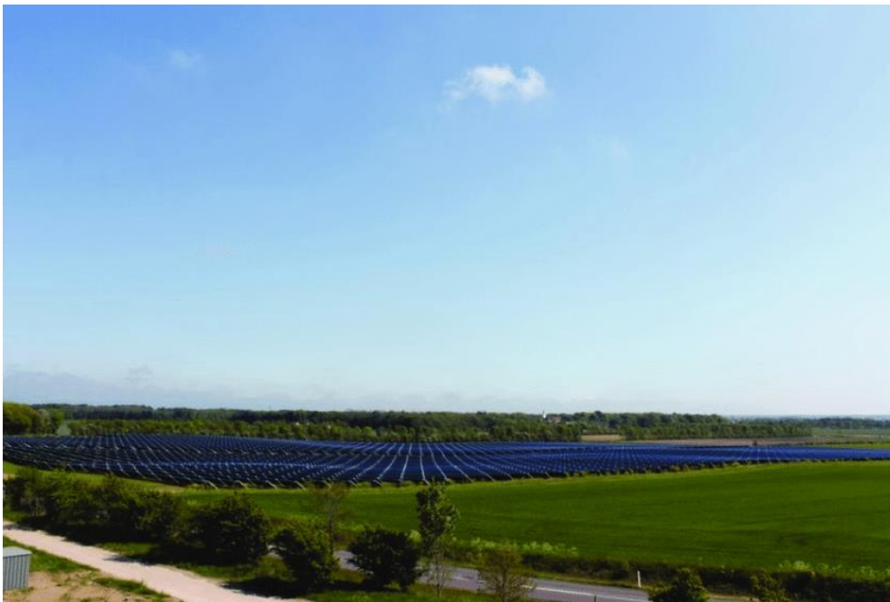
Solarna toplana Dronninglund sa površinom solarnog kolektora od 37.573 m 2 . 1
