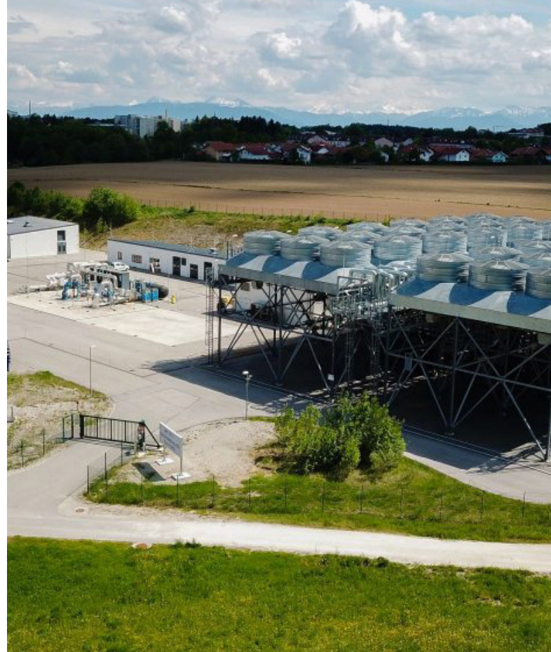
Геотермальная электростанция в Траунройте, Бавария, Германия. Источник: Equitix
