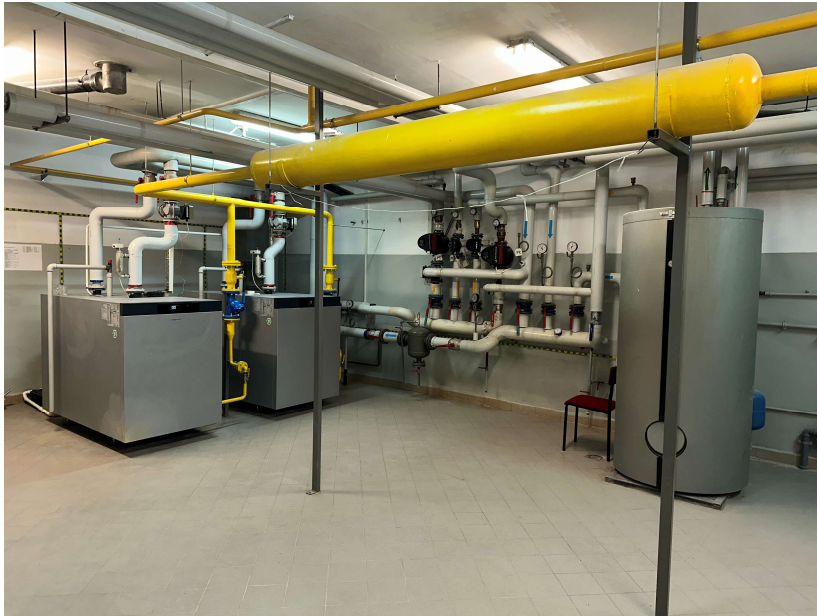
Fot. 1 Kotłownia gazowa c.o. oraz c.w.u. (autor Piotr Zaborowski)
